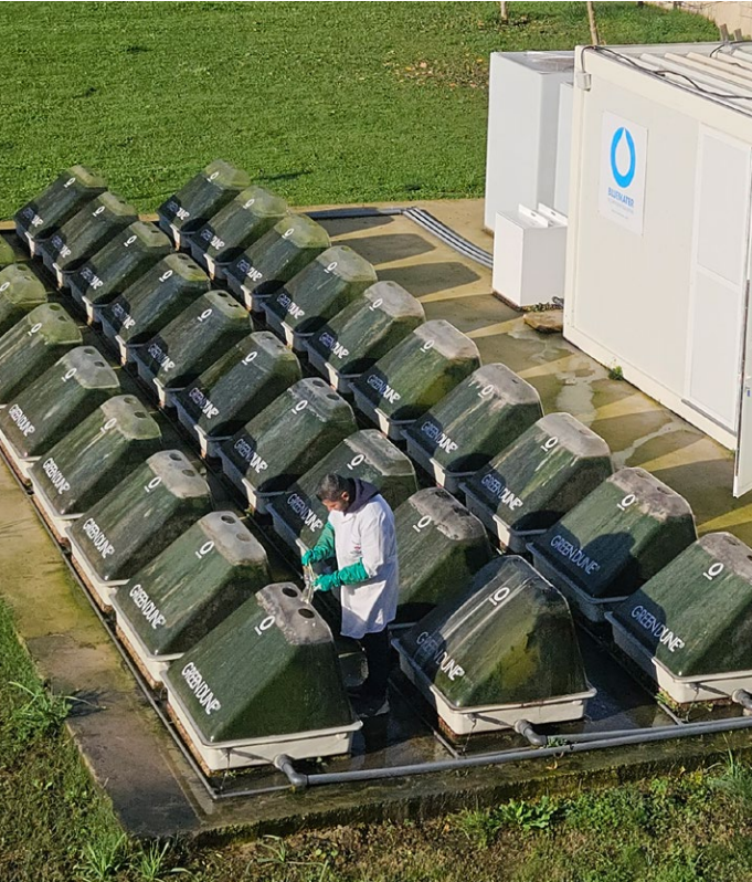
Şekil 5. Türkiye'deki Dilovası Atıksu Arıtma Tesisinde kurulu RHE-MEDIATION sistemi.
