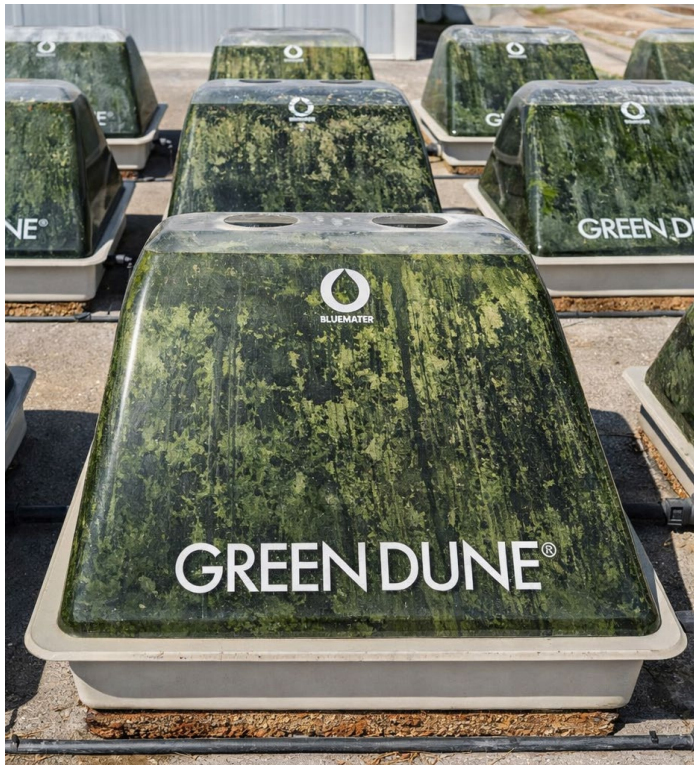
Figura 3: Fotobioreattori GREEN DUNE® installati presso l'impianto di trattamento delle acque reflue di Thrasio, Grecia.
